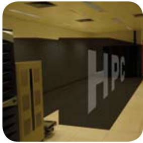
Der Raum für den Supercomputer an der TU Wien © TU Wien
