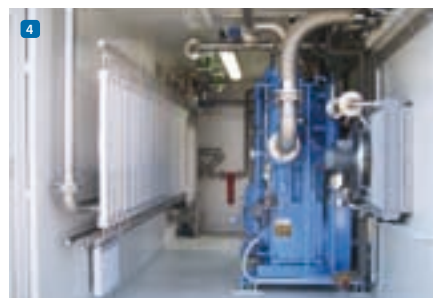
Blick in die Biogas-Anlage (Bruck an der Leitha)
