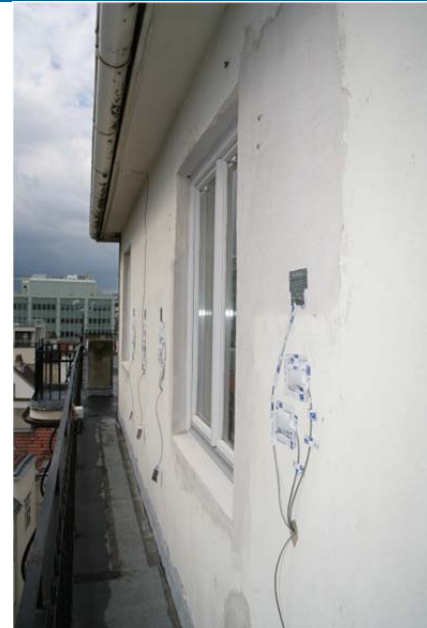
Abbildung 2 (rechts): Mess-Sensorik für die verschiedenen Ebenen im Putz vor der Putzaufbringung
