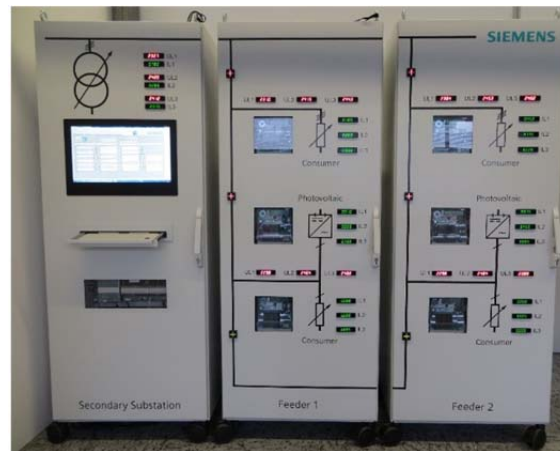
Abb. 1: Siemens Versuchsanlage für ein intelligentes Niederspannungsnetz
