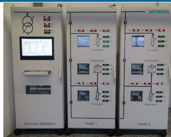
Abb. 1: Siemens Versuchsanlage für ein intelligentes Niederspannungsnetz
